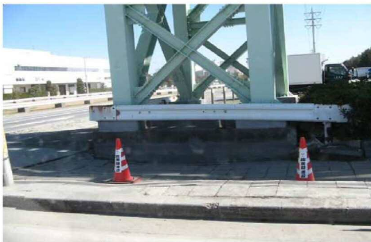
高瀬町 地盤地下により基礎杭の影響で40cm抜上り
