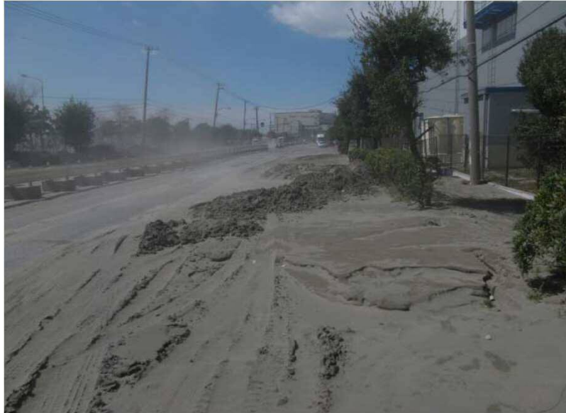
道路の噴砂状況
